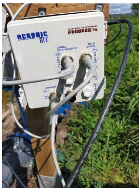
Fig.28. Programador GPRS para sectorización del riego.
