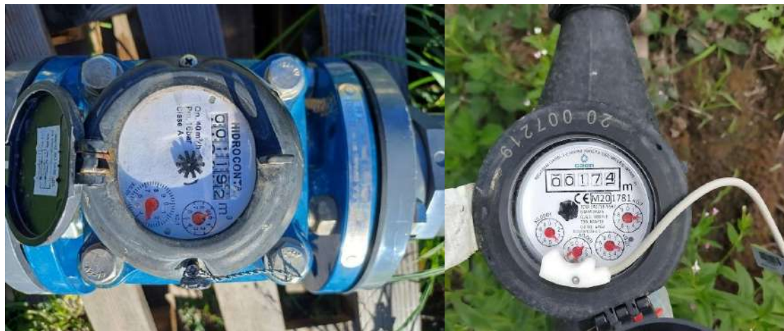
Fig.39. Contadores de agua.
