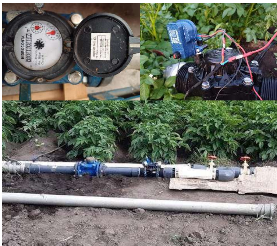
Fig.36. Contador y válvulas empleadas en el ensayo.
