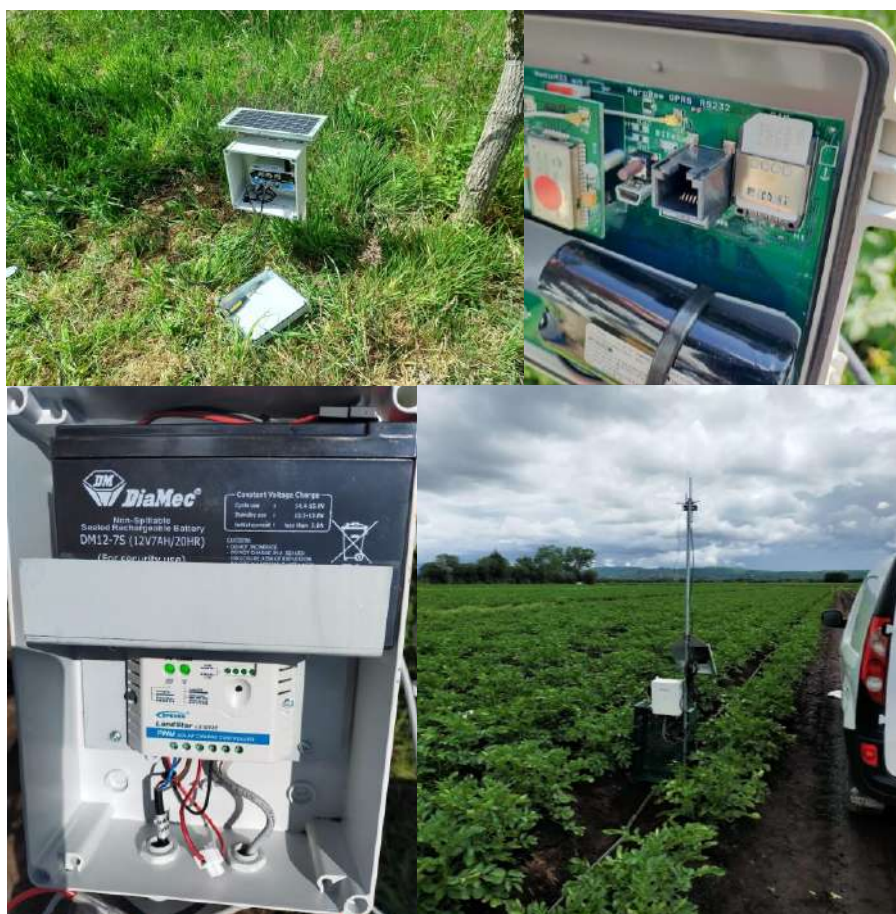
Fig.29. Programadores con omnidireccional para comunicación por radio, para conectar con módulos externos, y sistema autónomo de alimentación formado por un regulador solar 12V 120W, una batería 7 A 12 V y un panel solar.
