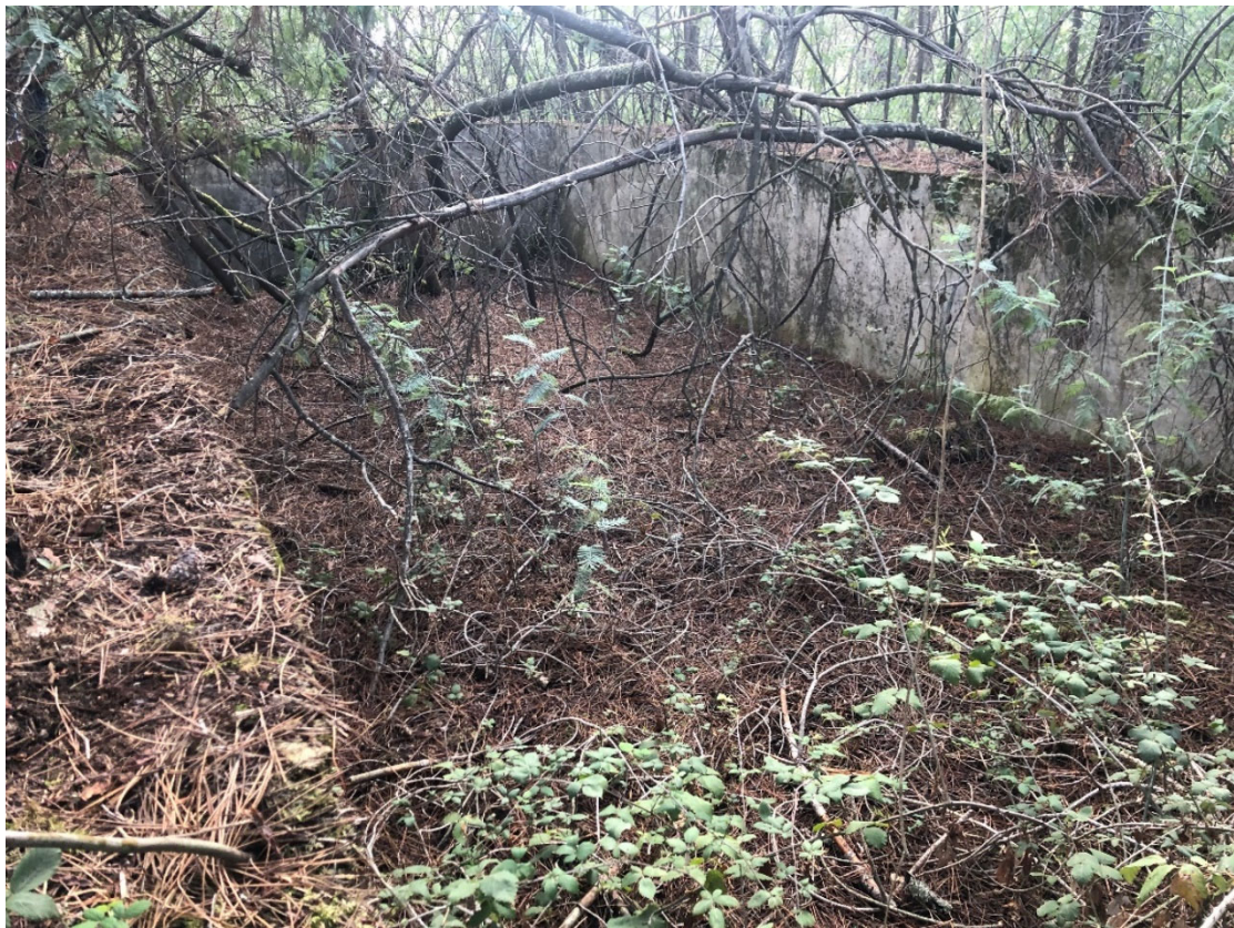
Figura 1.1.1. Estado inicial da balsa de formigón
