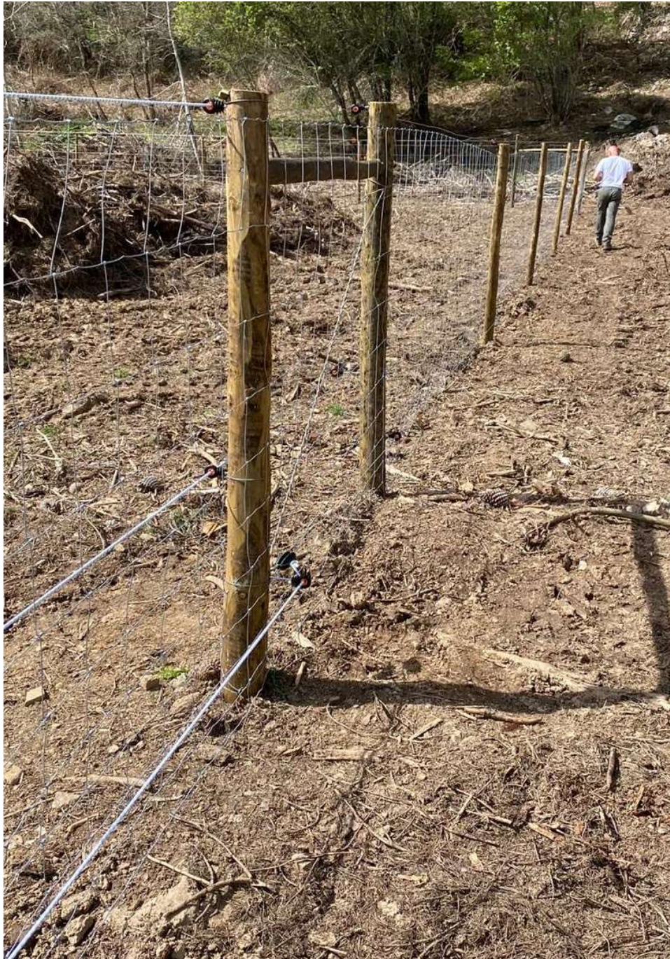
Figura 3.2.1.- Cierre de malla fija instalado.
