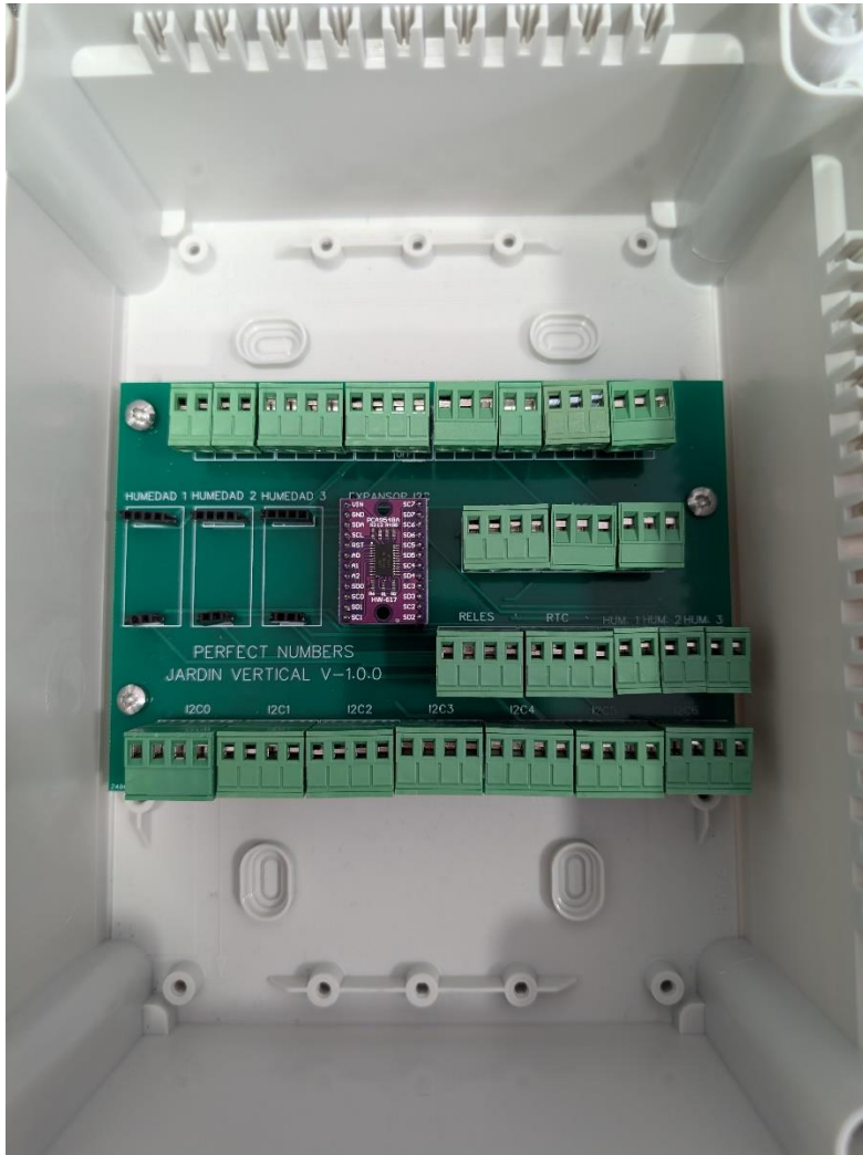
Figura 29. Caja auxiliar de conexiones
