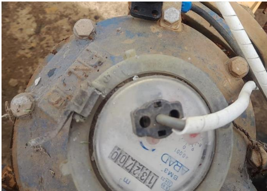
Ilustración 50: sensor instalado en el contador.
