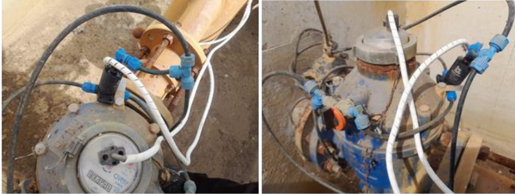
Ilustración 49: detalle de instalación de electroválvula.
