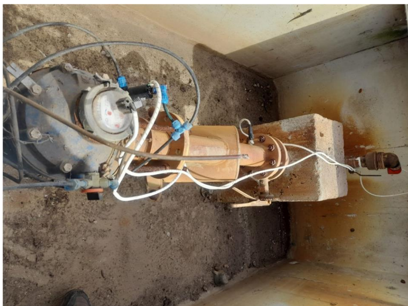
Ilustración 48: sensor de presión y electroválvula instalado en una caseta
