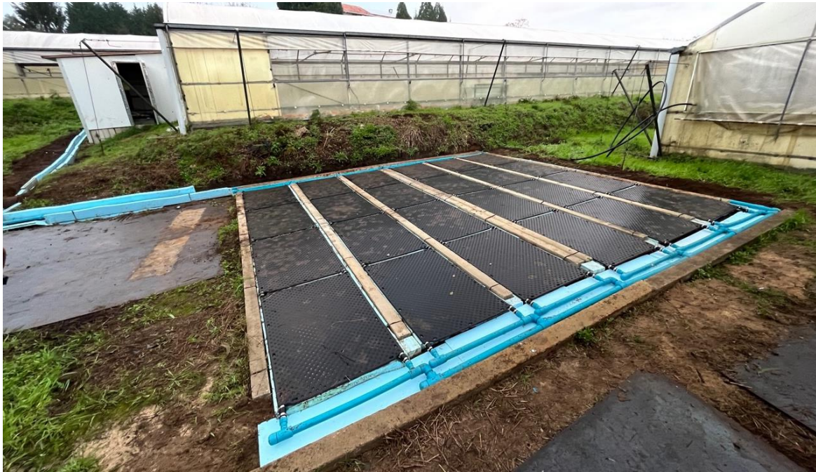
Figura 9: Circuito de captación de calor formado por paneis solares entre viguetas de formigón e enriba de placas de poliuretano extrusionado.
