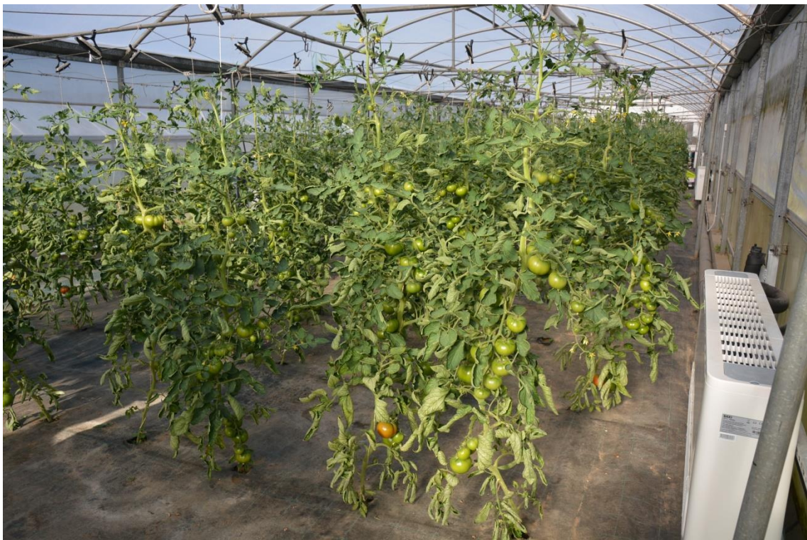
Figura 3: A man dereita se pode ver un dos cinco fancoils que forman o circuíto de climatización do invernadoiro.
