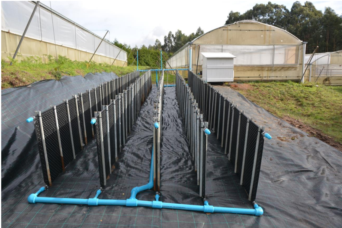
Figura 2: Circuíto de captación de calor formado por cinco valos xeotérmicos situados no interior da pilla.
