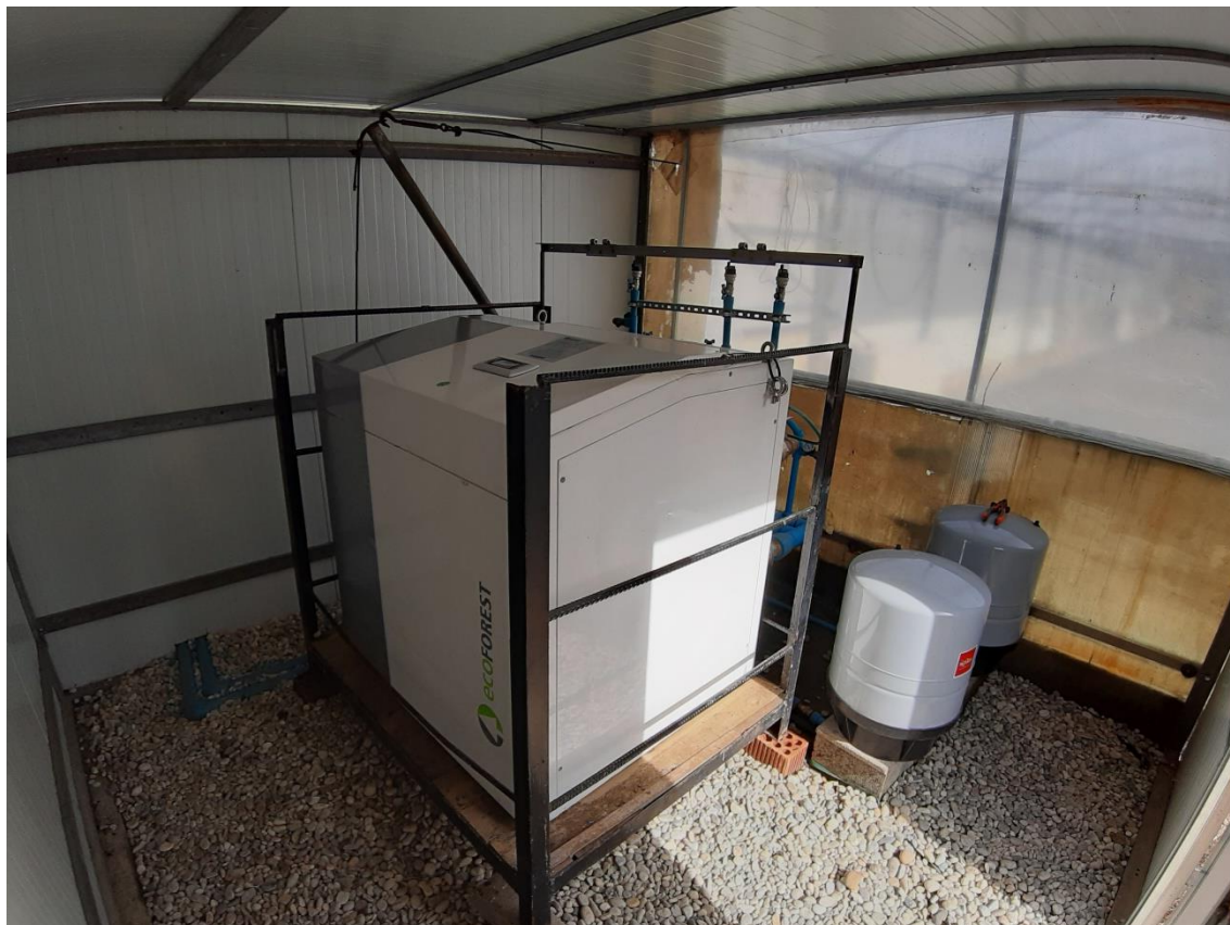
Figura 4: Vista bomba de calor utilizada na sala de máquinas.
